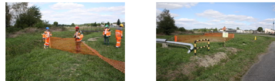
Figure 7 : Exemple de mise en place d'un balisage d'un site sensible (Source : © Biotope)
