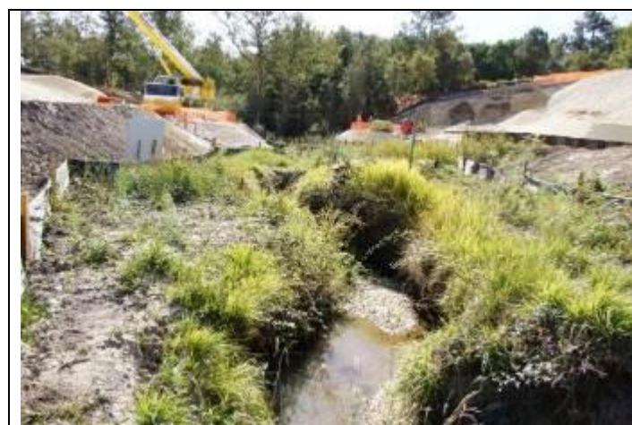
Ruisseau déboisé mais dont les souches, les berges et le lit ont été conservés afin de se végétaliser rapidement (P.Fournier – GREGE).
