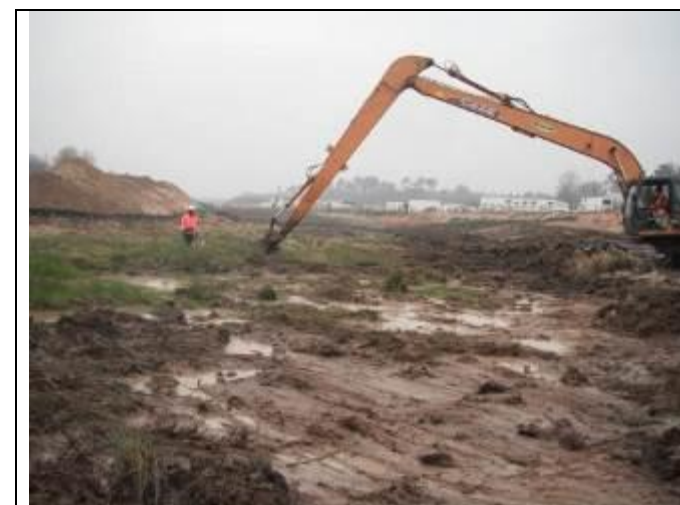
Griffage d'une zone humide large à l'aide d'une pelle mécanique à grand bras (C.Bout – GREGE).
