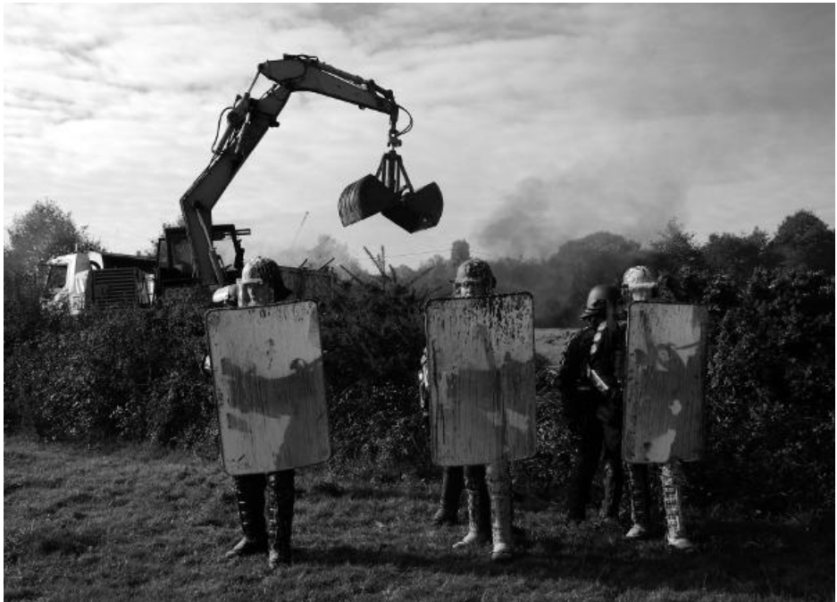
Destruction de la Gaité
